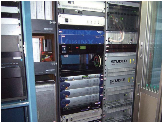
■ 整然とまとめられたラックエリア
